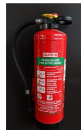
Abb. 22: Feuerlöscher vor Ort
