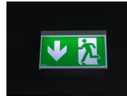
Abb. 9: Notausgang, Fluchtweg Kennzeichnung über Türe
