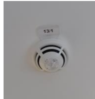
Abb. 17: beispielhaft automatischer Rauchmelder (nur in Bauteil A)
