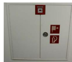
Abb. 20: Wandhydrant vor Ort
